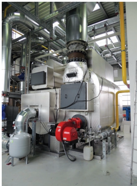
Rys. 5. APC z wbudowanym palnikiem gazowym odzyskująca ciepło ze źródła geotermalnego i produkująca wodę gorącą na potrzeby MSC
